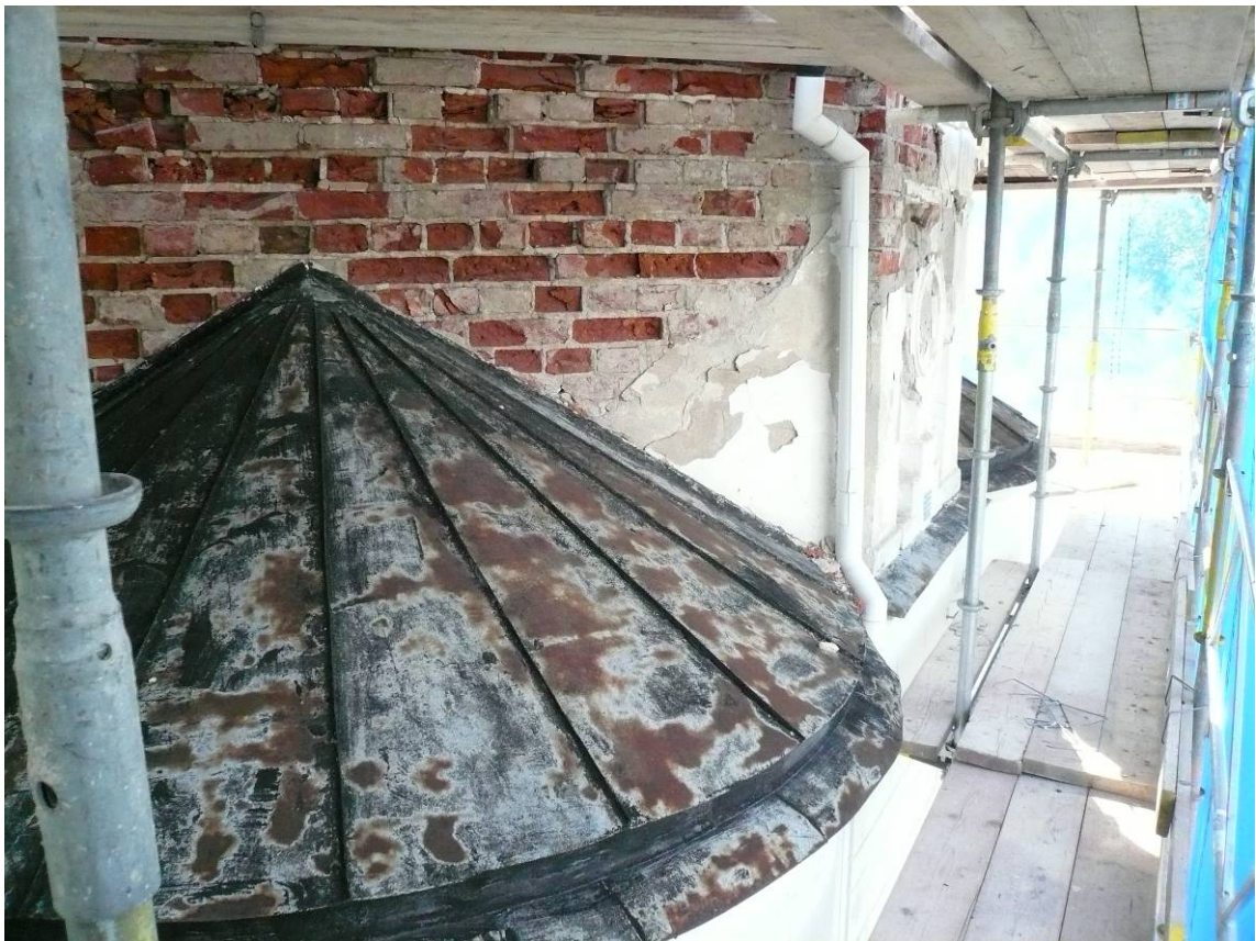
Byggnadens övre del, i höjd med absidernas tak; befintligt skick före åtgärder. Skadorna i puts och mur- verk är orsakade av vatteninfiltrationer i murkrönen, i höjd med betongkupolens fot. Absidernas ur- sprungliga plåttäckning är väl bevarad, med endast ytliga rostangrepp.
