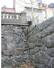
Skador på stödmurarna i NV
