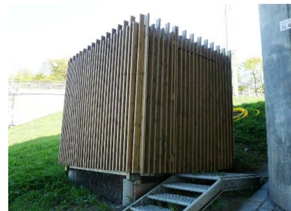
Transformatorstationer kan fodras med t.ex. träribbor.
